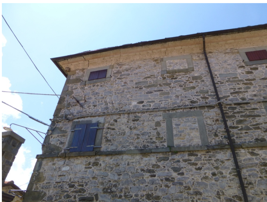
Figura 10. Uglianaldo (MS) Edificio in muratura con lesione passante allo spigolo
