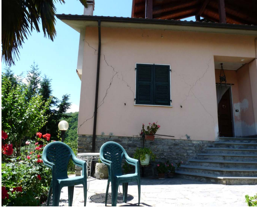
Figura 7. Casola in Lunigiana (MS) - Edificio in muratura con crepe larghe e profonde.
