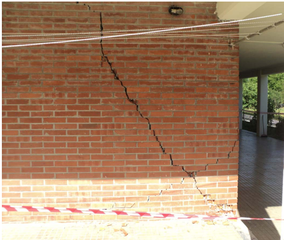
Figura 8. Equi Terme (MS) Edificio in cemento armato con crepe nelle tamponature
